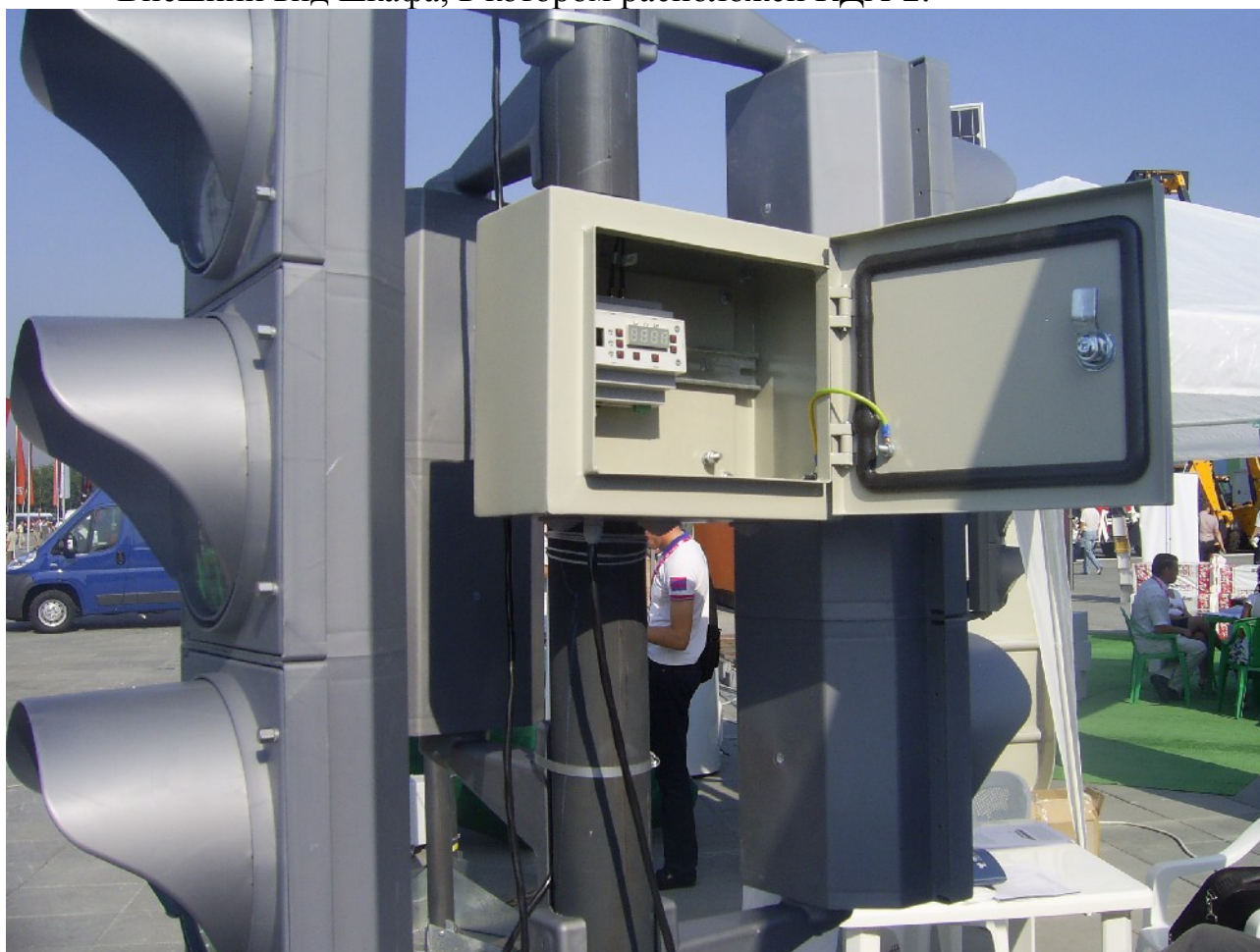
Внешний вид шкафа, в котором расположен КДА-2.
